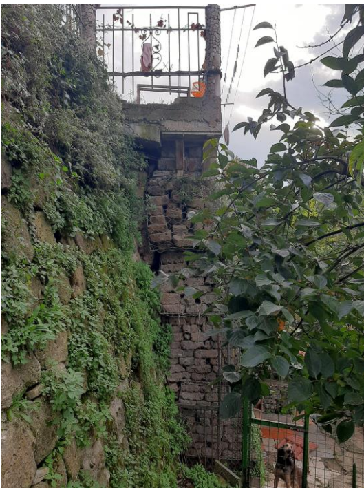
Soletta in c.a. e sottostante muro a secco/gabbionata (insistono su altra proprietà)
