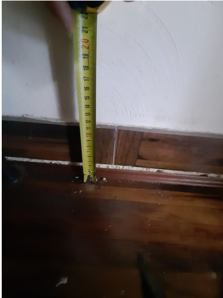
Distacco tra pavimento e zoccolo battiscopa presente nel locale al piano S1 adibito a soggiorno-pranzo
